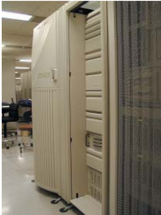
▲ES7000本体はハウジングサービスを利用し、日本ユニシス情報システムのデータセンター内に設置されている
